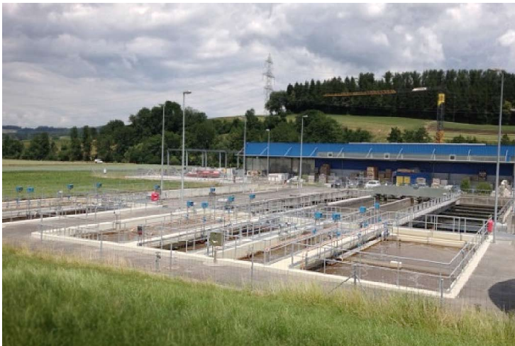
EDAR "oberes Surbtal". La parte de tratamiento biológico de la planta consta de tres trenes de tratamiento idénticos
