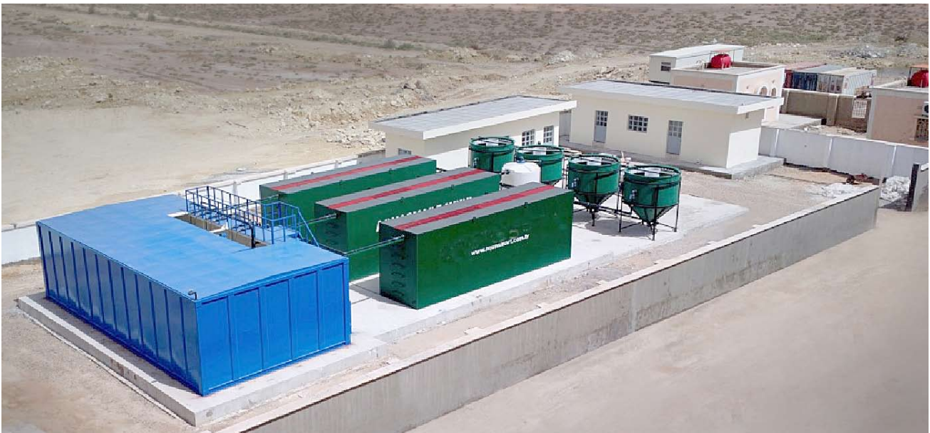
Planta EDAR en contenedores con Mutag BioChip™ , instalada en Iraq en 2014
